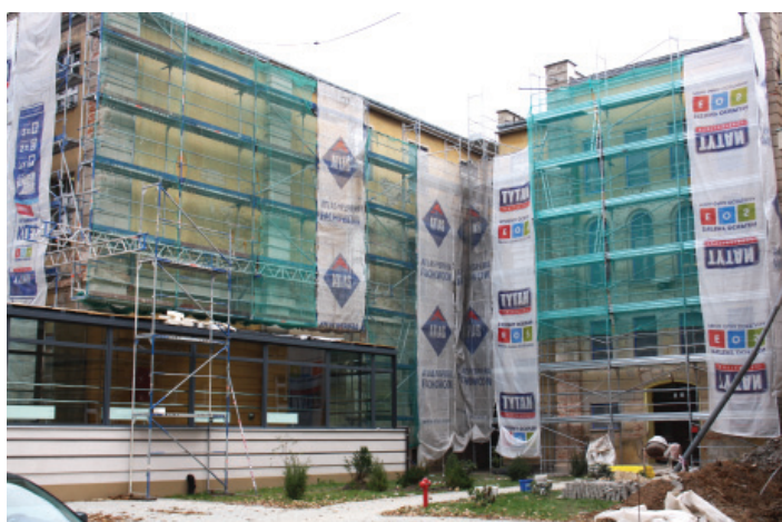
Obecnie realizowana inwestycja w Zespole Szkół Ogólnokształcących w Strzelinie polega na wykonaniu termomodernizacji budynku.
