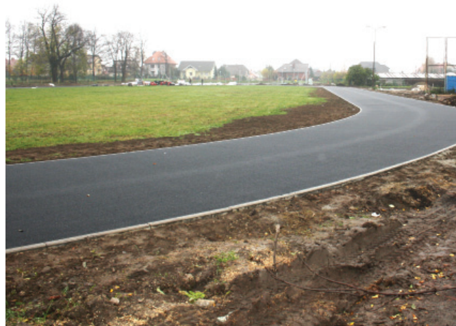
Budowa kompleksu sportowego pod nazwą „Królowa Sportu” przy Centrum Kształcenia Zawodowego i Ustawicznego w Strzelinie.
